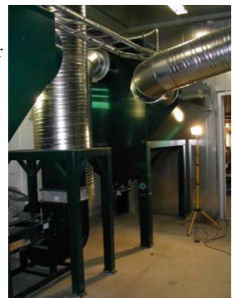
Teknisk utstyr kan også bygges inn i et eget rom for støy- og varmeisolasjon, f.eks som en forlengelse av kabinen eller på en av langsiden.
